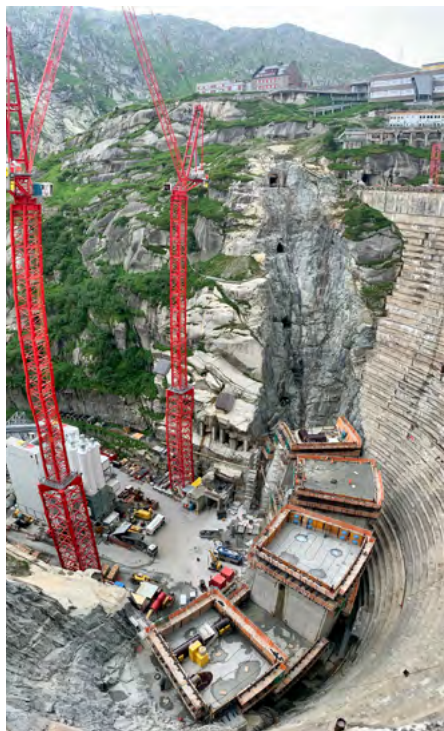
Bild 2: Blick auf die ersten im Bau stehenden Betonblöcke der neuen Bogenmauer Spitalamm.
